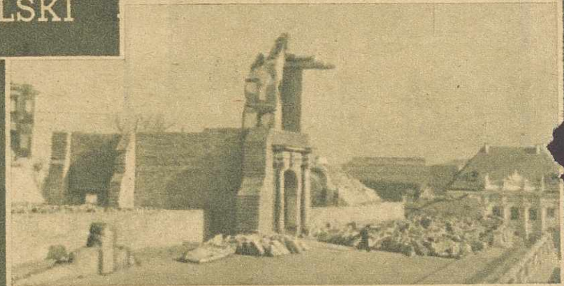
Rozpoczęto już wstępne prace przy odbudowie Zamku Królewskiego w Warszawie. Słynna „Brama Grodzka” uprzednio zabezpieczona podlega rekonstrukcji w/g starych planów
