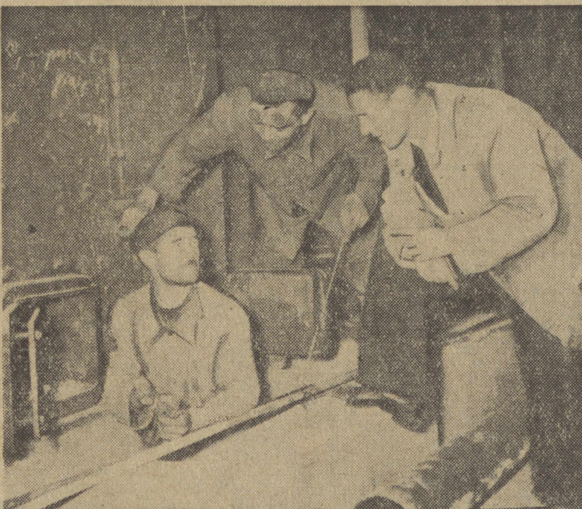
Oszczędność opatu dla centralnego ogrzewania zależy m. in. od dobrego stanu kotłowni, przewodów i instalacji.
