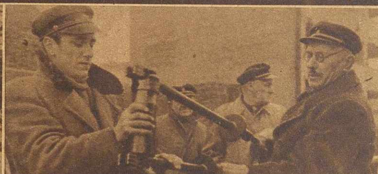
Wymiana bezpieczników pod prądem w stacji ulicznej to zadanie wielce ryzykowne. Dlatego też elektrycy pracują w gumowych rękawicach i używają specjalnych izolowanych szczypliec
