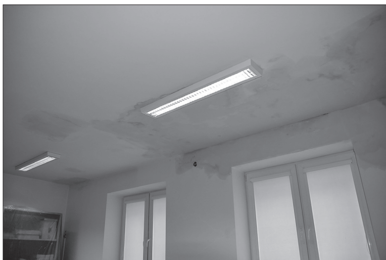
Fot. 5. Skutki wadliwie wykonanego tarasu (aut. zdj. A. Peszel)
